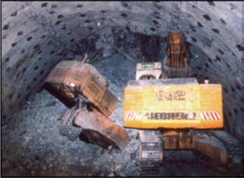
Şekil 1. Galgenberg Tüneli'nde Yaşanan Göçük (Riedmueller ve Schubert, 2002)
